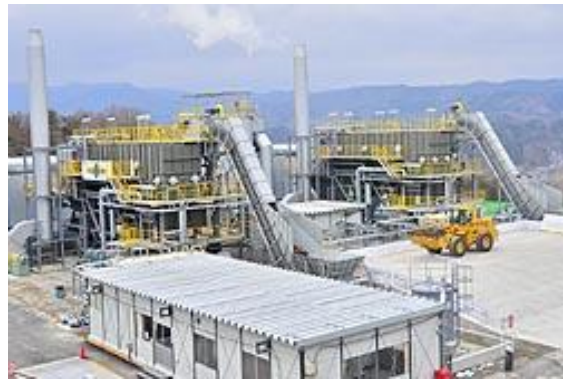
図 仮設焼却炉（岩手県宮古市）
