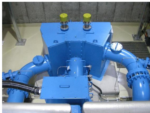
写真：馬野川小水力発電所（伊賀市）
