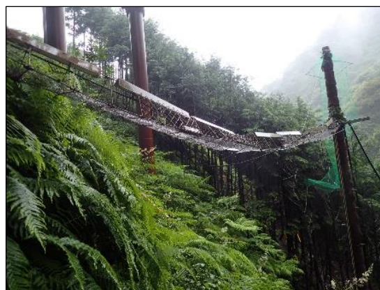
熊野尾鷲道路（Ⅱ期）での設置状況
