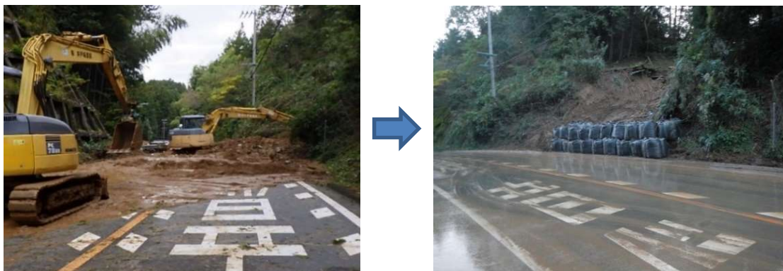
国道 166 号 土砂崩落 緊急対応状況
