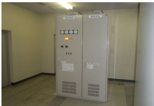
送水ポンプ所の直流電源設置状況
