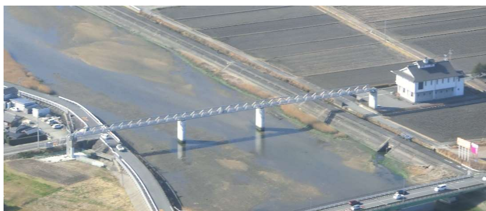
写真は松阪処理区管内の三渡川に架かる水管橋 (写真下に見えるのは国道 42 号(三渡橋))
