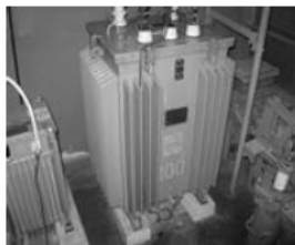
変圧器 (トランス)
