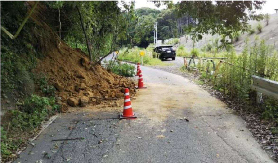
崩落後の状況
