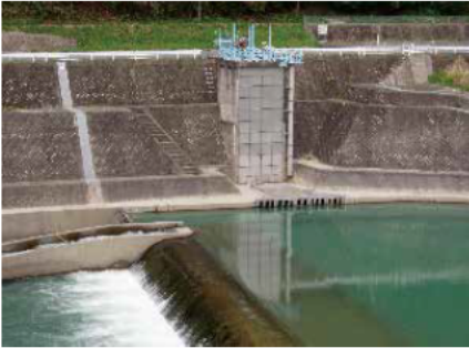
写真：南勢志摩水道 津留取水口
