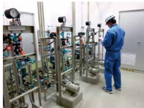
薬品注入設備の点検
