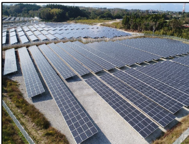
マス型構造に設計された発電設備
