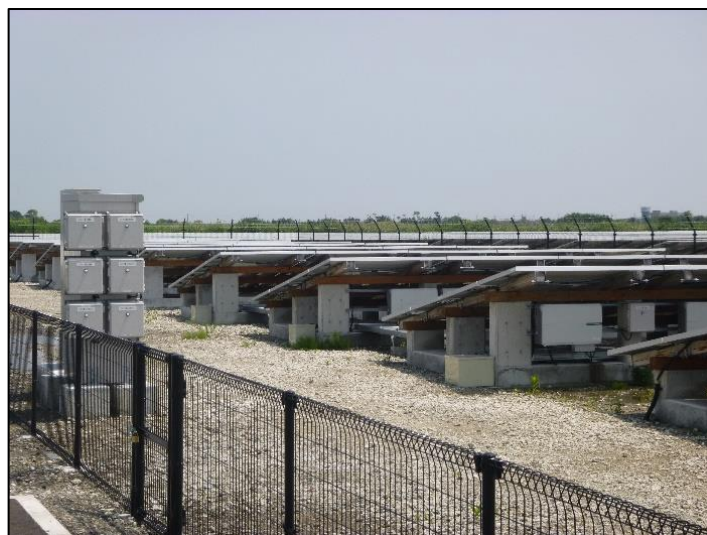
50KW 自立発電所
