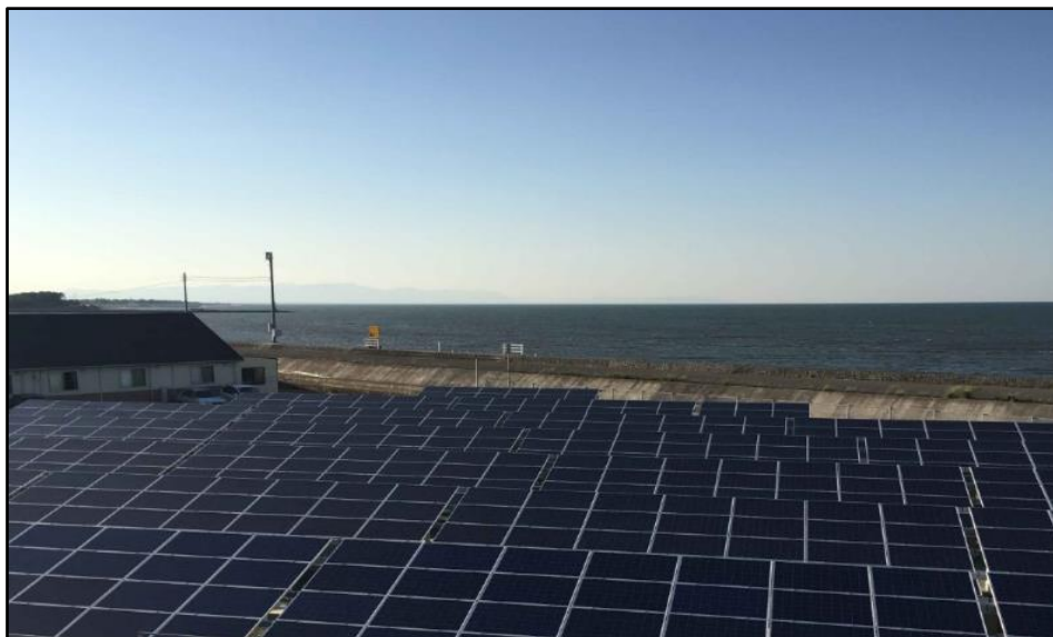
イクト太陽光発電所の外観
