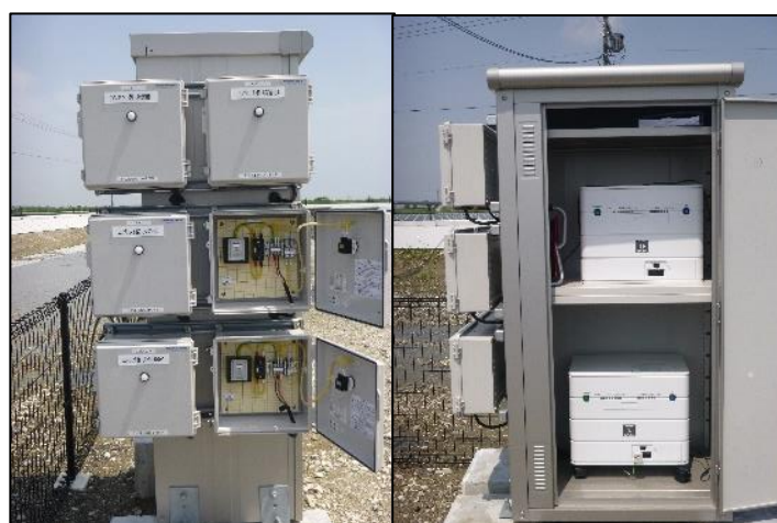
非常用コンセント、非常用バッテリー
