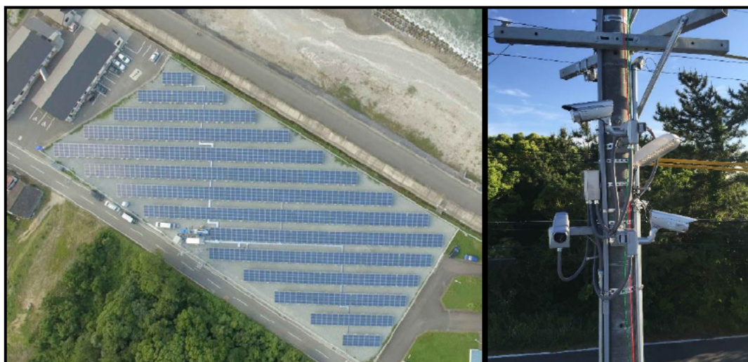
沿岸部に設置された太陽光発電施設と防犯対策設備
