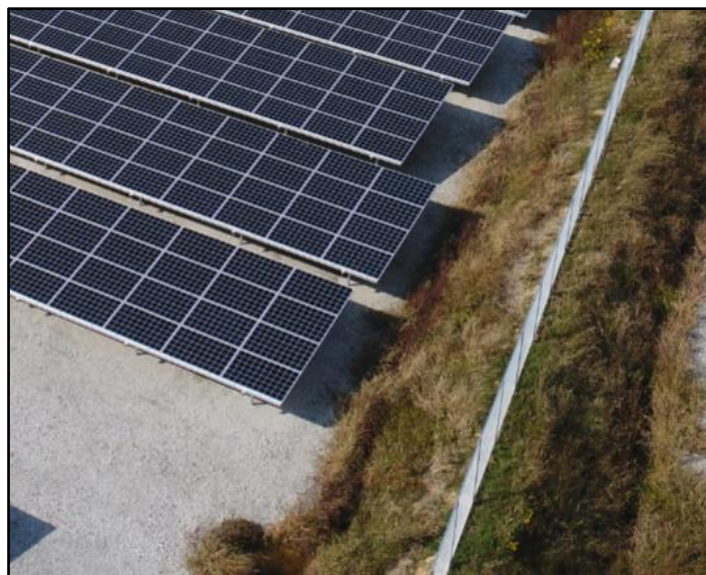
設備境界に植物を採用した地盤強化対策
