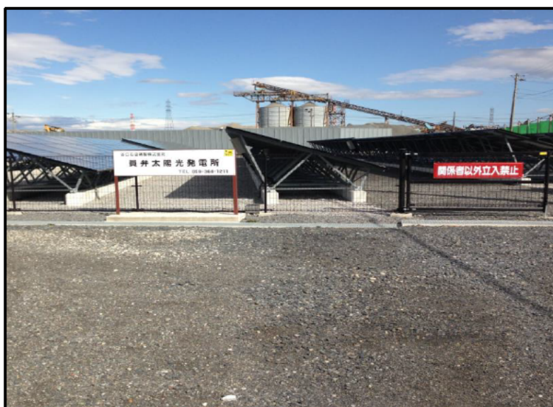
こまめに現場管理された太陽光発電施設
