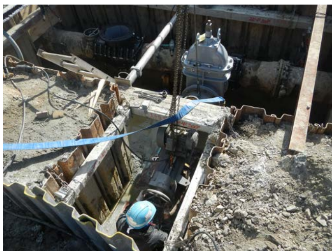
布設替に伴う不断水分岐工事の施工状況 (内径400 耗送水管布設替)
