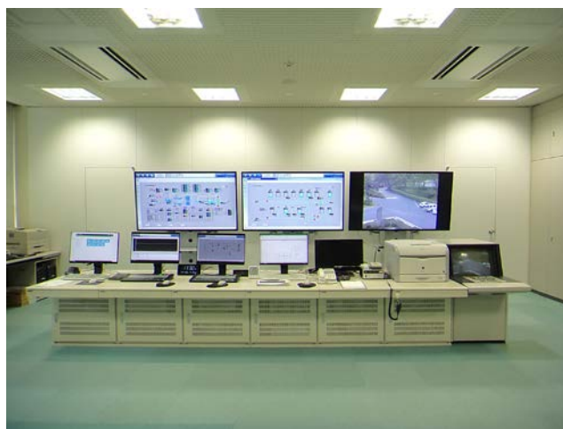
更新が完了した播磨浄水場の中央監視制御装置 (平成30年度完了)
