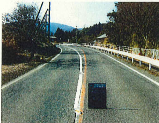
センターライン及びゼブラが消えており、車両通行が危険な状態
