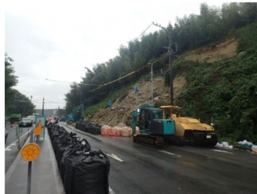
一般国道 421 号 応急対応状況
