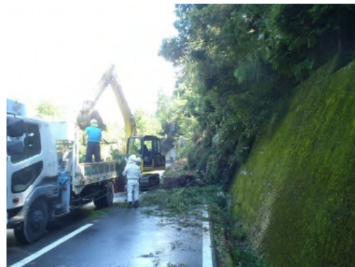
一般国道 169 号 応急対応状況
