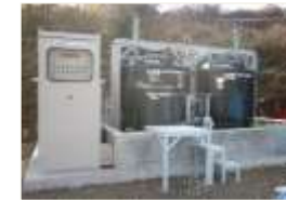
写真 霧状酸化剤注入装置
