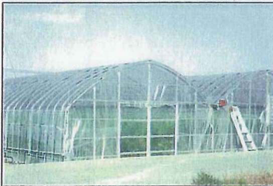
パイプハウス（被害が大きかった）
