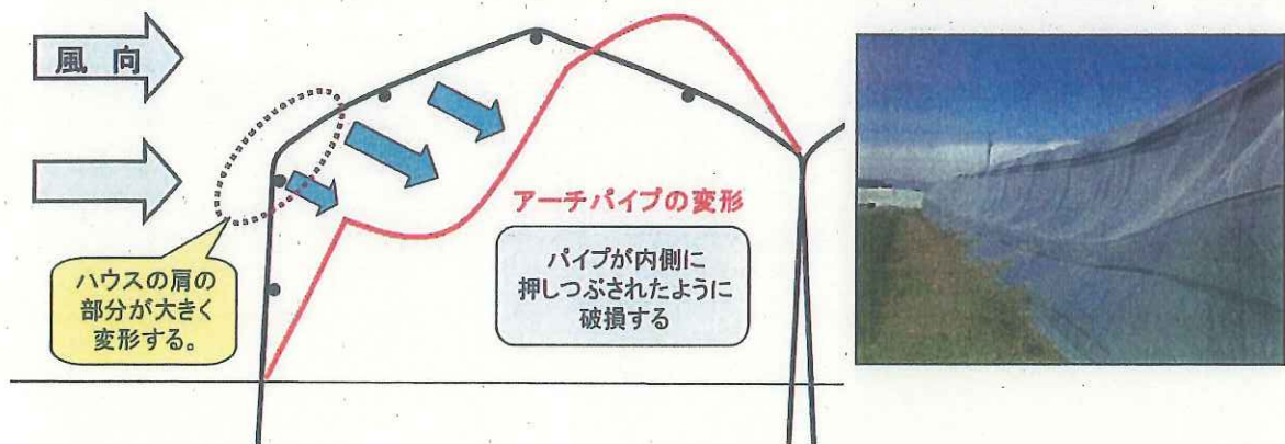
図-1 風上側の肩部分から内側にパイプが大きく変形するパターン(原図:森山)
