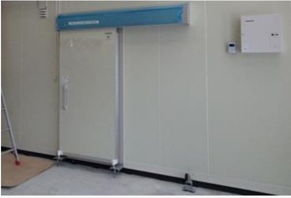
(写真 1) 冷凍保管庫
