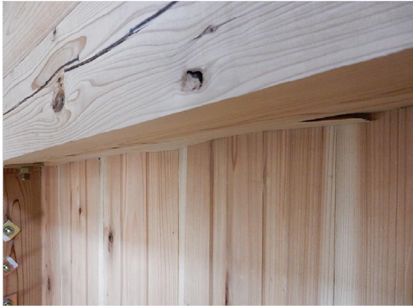
写真 2-3 スギ厚板張り床構面 試験体 No.2 面内せん断試験後 [ 加力側の桁 ] 厚板に打ったN90釘 が桁の材縁部を引き 裂いた様子
