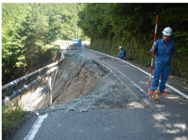
被災状況 平成30年8月27日 撮影
