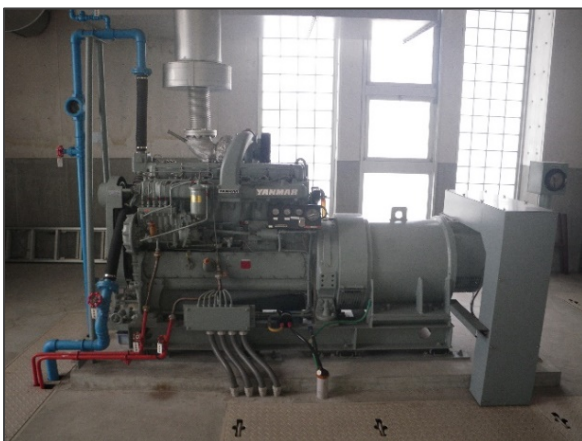
非常用予備発電設備
