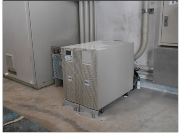
無停電電源装置
