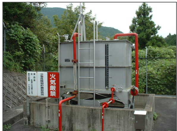
燃料貯蔵タンク
