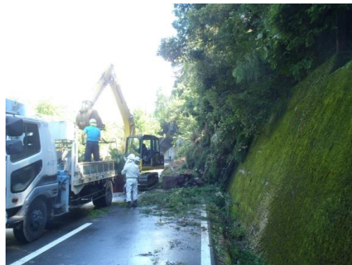
一般国道 169 号 応急対応状況
