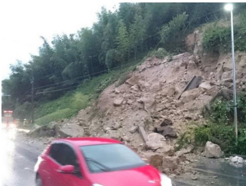
一般国道 421 号 被災状況
