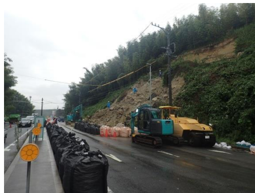
一般国道 421 号 応急対応状況
