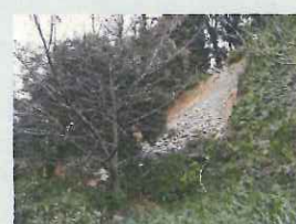
田丸城跡石垣崩落 (玉城町)
