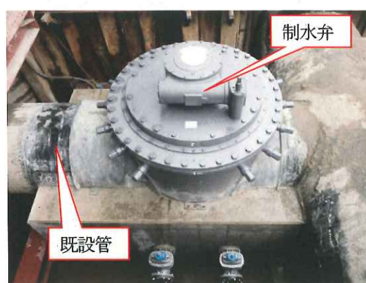
不断水工法による制水弁の設置状況 (内径1350mm 制水弁取替)
