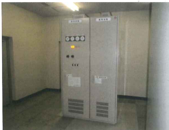
送水ポンプ所の直流電源設置状況 (平成29年度更新)
