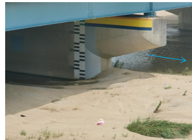
量水標（朝明川、川越町にて設置）
