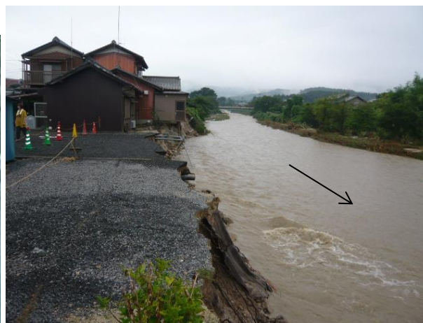
H20. 9. 2～3 田光川護岸侵食 (菟野町田光)
