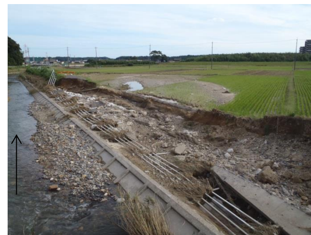
H24. 9. 30 足見川堤防決壊 (四日市市波木町)
