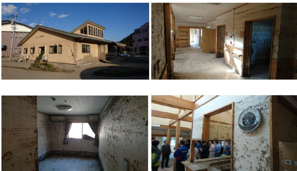
被災した高齢者福祉施設の様子
