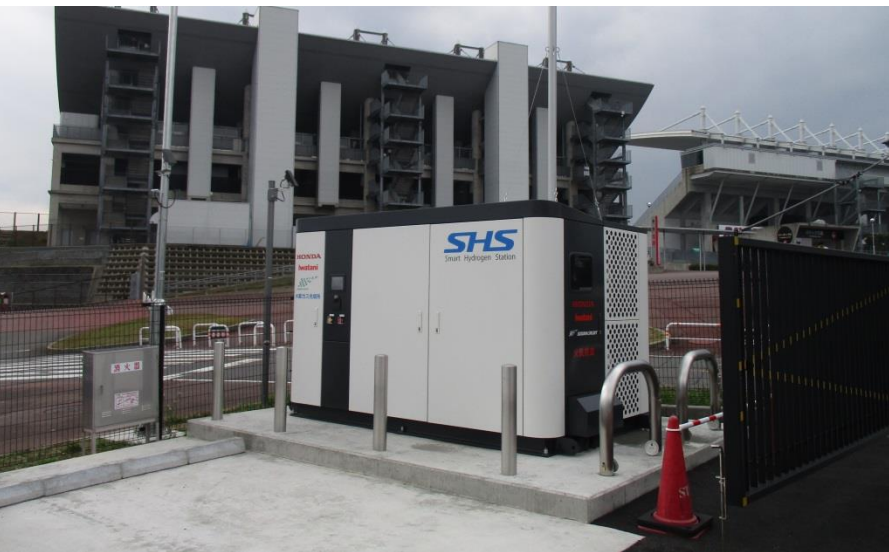
小型水素ステーション(鈴鹿サーキット内)
