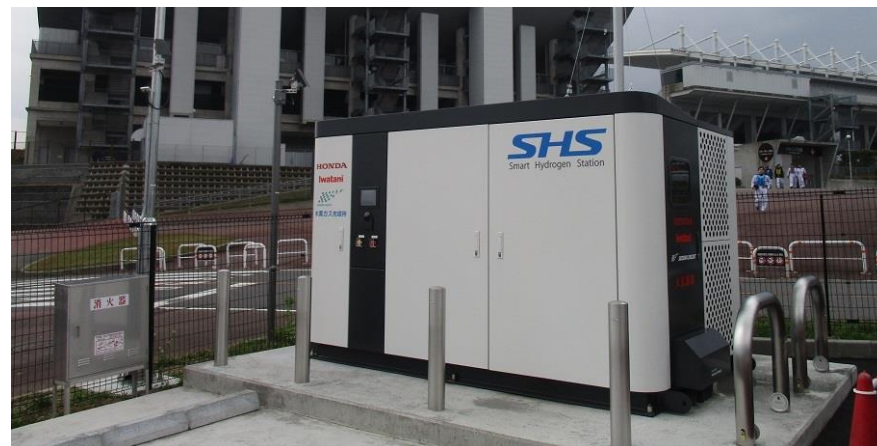
※鈴鹿サーキット内小型水素ステーション(SHS) 水素ステーションの整備推進
