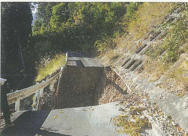
陥没した林道三峰局ヶ岳線（松阪市）
