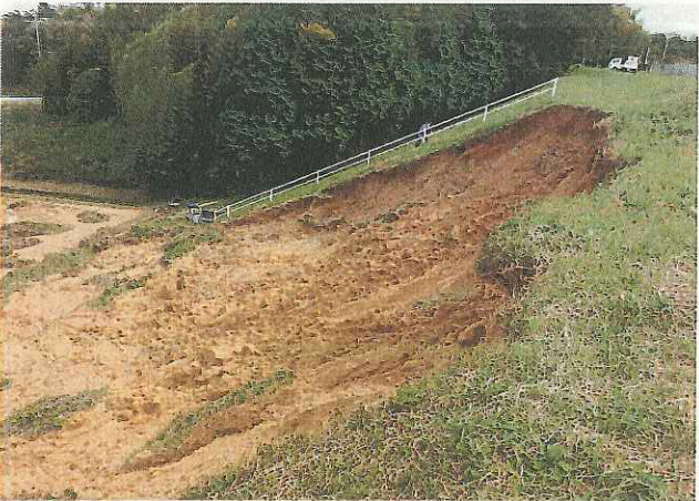
堤体が崩壊した農業用ため池（松阪市）
