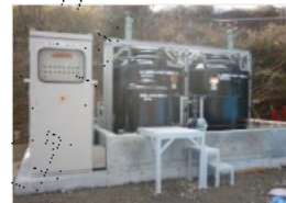
写真 霧状酸化剤注入装置
