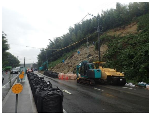
一般国道 421 号 応急対応状況
