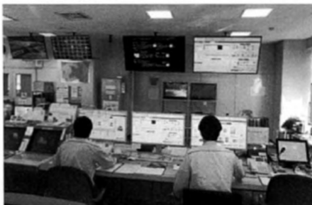
高野浄水場中央監視の状況
