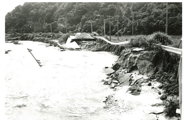
S49. 7. 25 朝明川右岸決壊 (四日市市萱生町)
