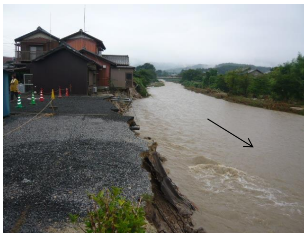
H20. 9. 2～3 朝明川護岸侵食 (菟野町田光)
