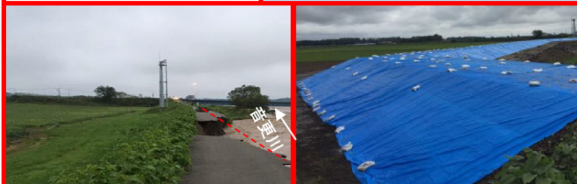
十勝川水系 音更川KP21.2左岸の堤防が決壊 8月31日に緊急復旧工事に着手し、9月5日に完了
