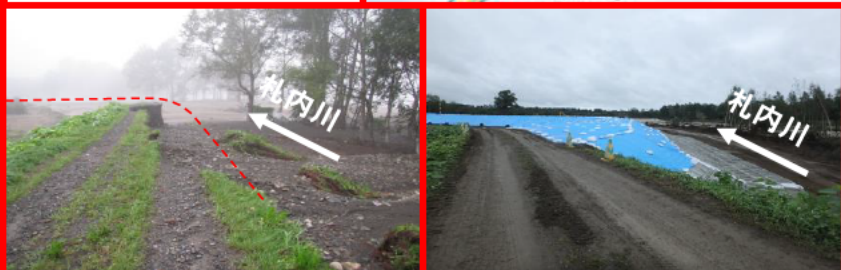
十勝川水系 札内川KP25.0左岸の堤防が決壊 8月31日に緊急復旧工事に着手し、9月7日に完了
