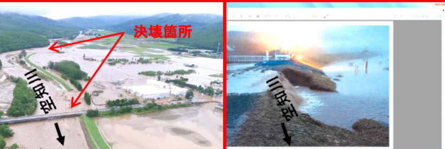
石狩川水系 空知川KP116.2左岸、KP117.0左岸の堤防が決壊 8月31日に緊急復旧工事に着手し、9月6日に完了
