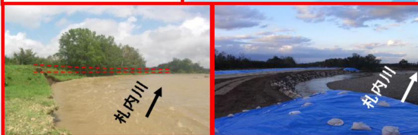
十勝川水系 札内川KP40.5左岸の堤防が決壊 9月1日に緊急復旧工事に着手し、9月7日に完了
