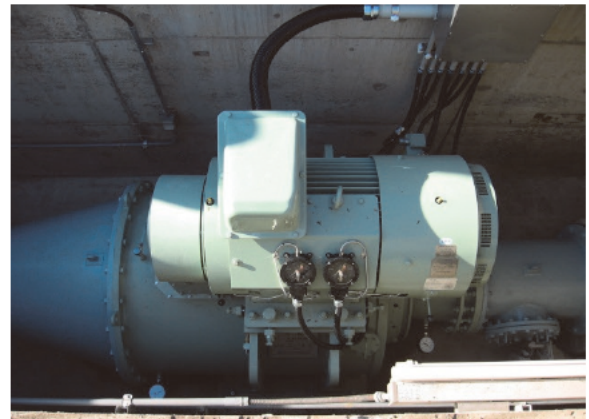
【小水力発電設備】
