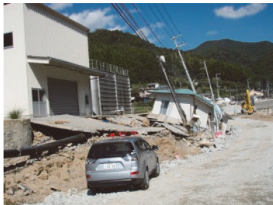
【浄水施設の被災状況(熊野市)】
