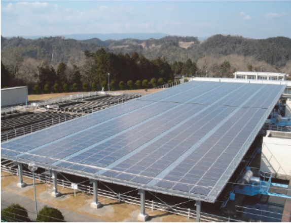
【太陽光発電設備】
