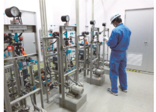
薬品注入設備の点検
