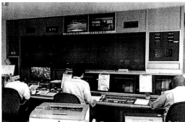
高野浄水場中央監視制御盤の状況
