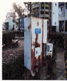
腐食した制御機ボックス（御浜町）
