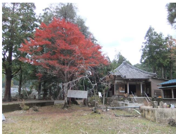
紀伊半島大水害により被災した楊枝薬師堂 （平成 23 年 12 月撮影）
