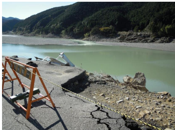
紀伊半島大水害による県道小船紀宝線の 路肩崩落 (平成23年12月撮影)
