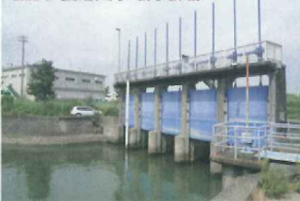
毛無川（防潮樋門・排水機場）
