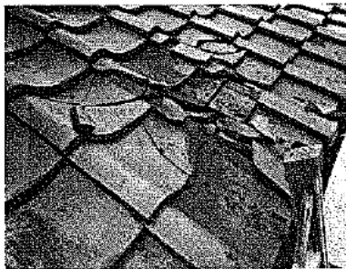
猿に壊された屋根瓦
