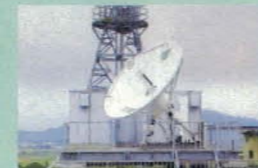
防災行政無線の整備
