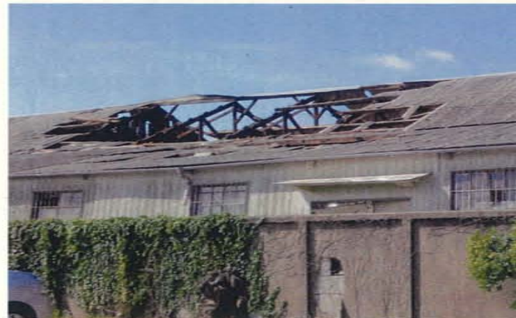
スレート屋根が飛散した非住家〔津地方気象台提供〕
