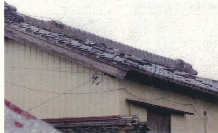
屋根瓦がめくれた住家〔三重県撮影〕
