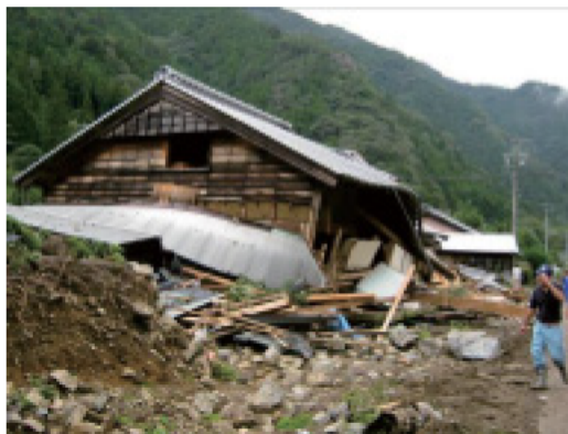
山腹崩壊（表層）による被害
