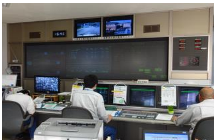
高野浄水場中央制御監視盤の状況
