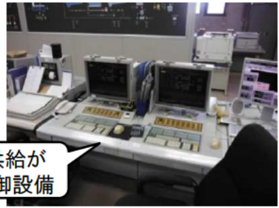
老朽劣化が進む汚泥脱水機
