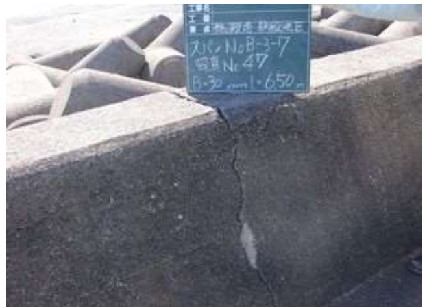
変状：ひび割れ(鵜殿港鵜殿地区)
