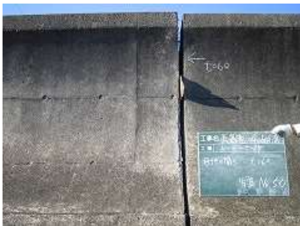
変状：目地の開き(長島港呼崎名倉地区)
