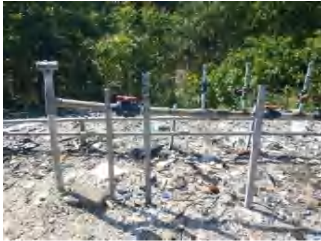
既設ガス回収井戸と配管
