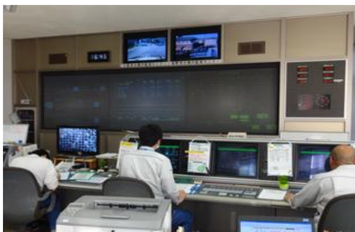
高野浄水場中央制御監視盤の状況
