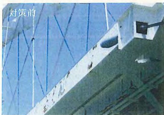
長年にわたる潮風や雨により鋼橋の上部工に、表面さびが発生している
