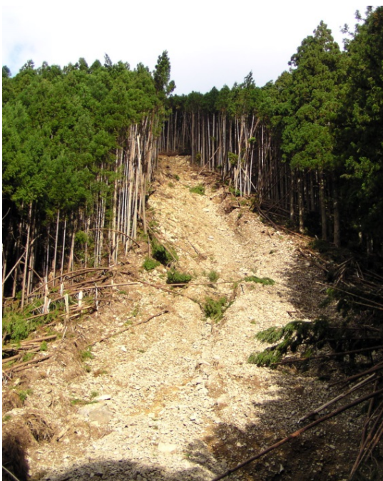
崩壊状況 (大台町(旧宮川村))
