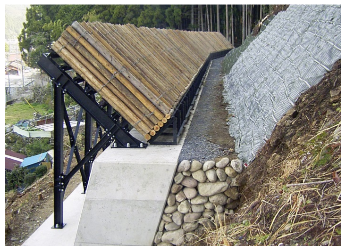
落石防止工の緩衝材 (熊野市)
