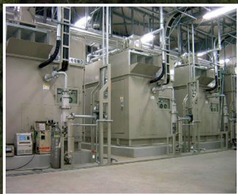
▲ガスエンジン式発電機
