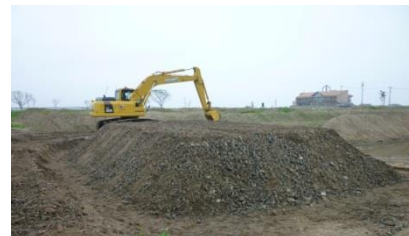
写真4-1. 鉄道敷きの バラスが混入した農地状況
